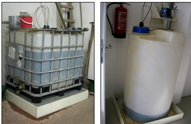
Obrázek 25, 26 Nádrž na koagulant – ČOV Vyžlovka (1000 EO), ČOV Němčice (500 EO)
