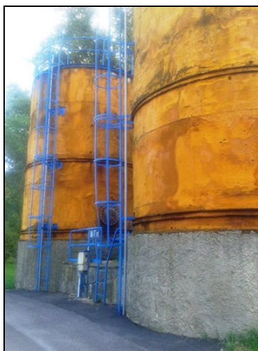
Obrázek 27 Gravitační zahušťování kalu v zahušťovacích nádržích – ČOV Rudná (9800 EO)
