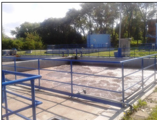
Obrázek 55 ČOV Rudná I – pohled na aktivační nádrž
