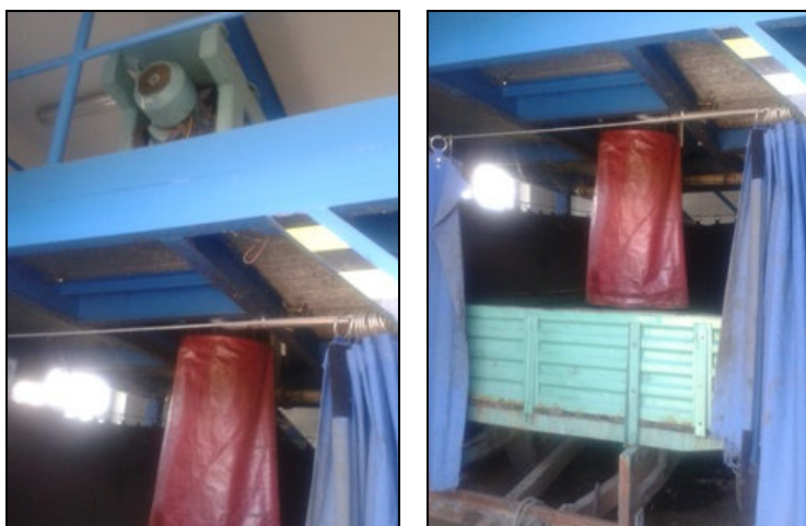
Obrázek 28, 29 Strojní odvodnění kalu (dekantační odstředivka) s valníkem na odvoz kalu – ČOV Rudná (9800 EO)
