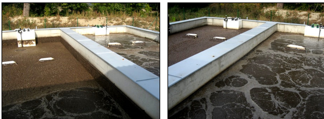
Obrázek 52, 53 Dvojice reaktorů SBR – v jedné nádrži probíhá fáze dekantace, druhá nádrž je ve fázi aerace – ČOV Žehušice (2000 EO)
