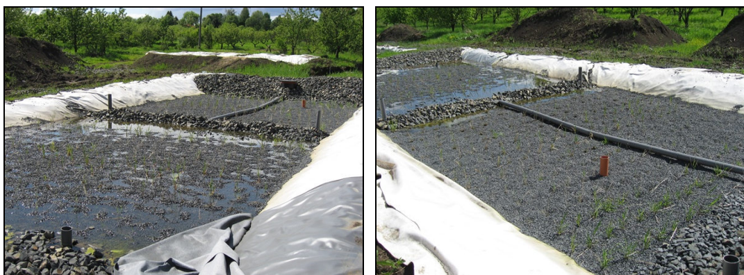
Obrázek 15, 16 Kořenová ČOV v obci Chrástce (ještě před uvedením do provozu)
